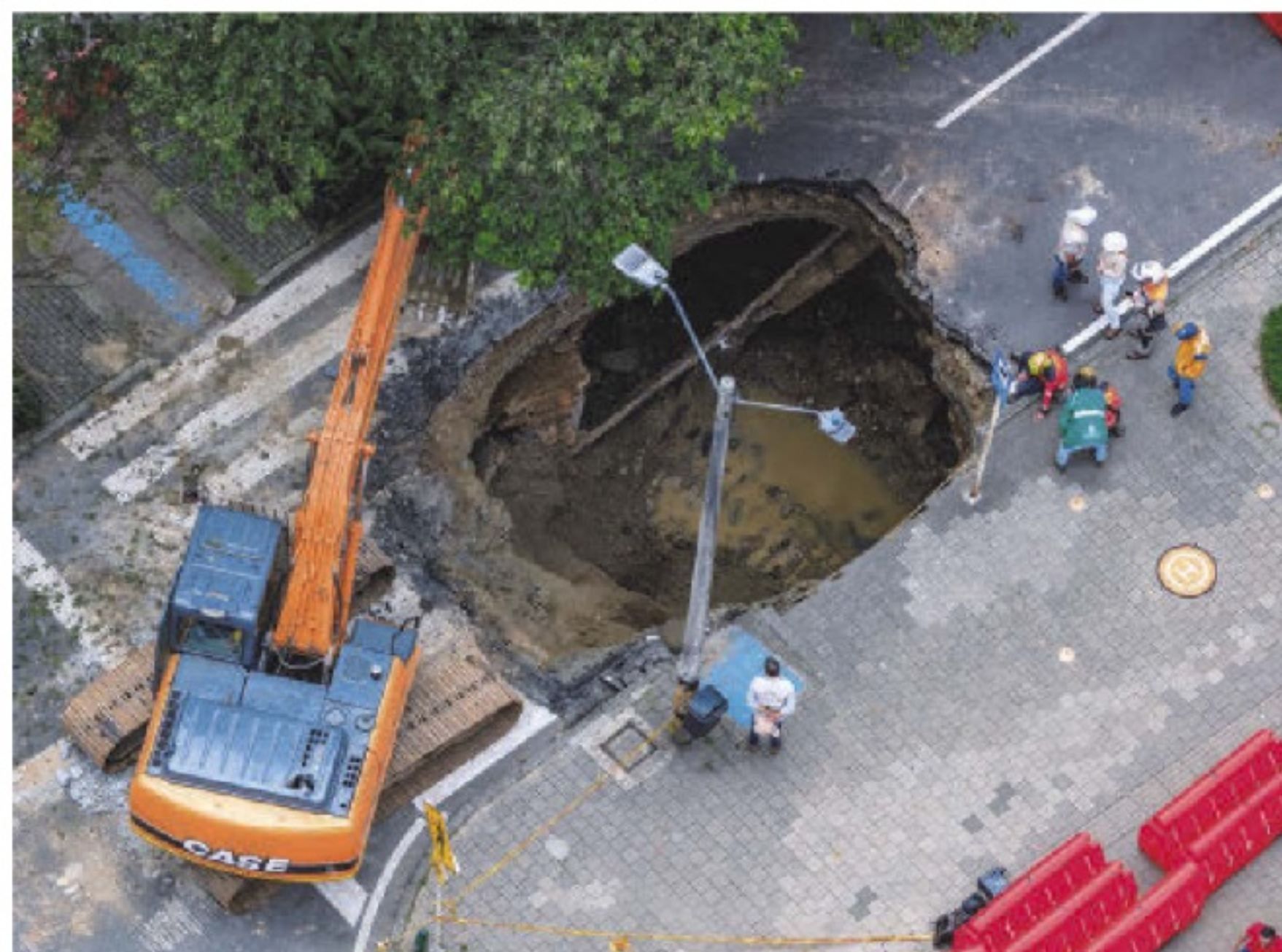
Así se ve el "cráter" en la avenida El Poblado, sentido sur-norte, a la altura del Hotel Dann Carlton. Los trabajos podrían tardar una semana o más dependiendo de los estudios técnicos. FOTO CAMILO SUÁREZ
